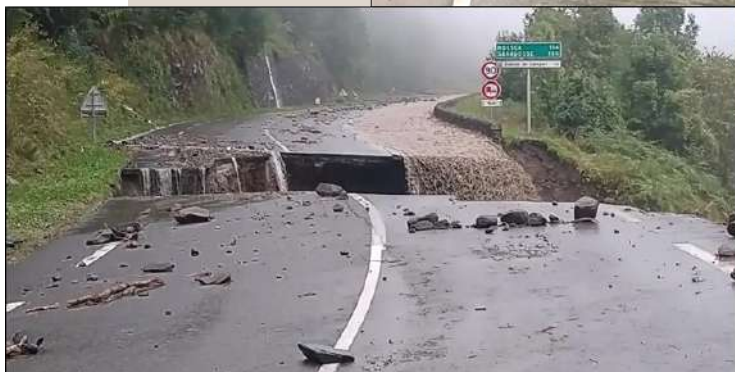
Figura 7. Cortes en las dos principales vías de conexión por carretera con Francia en el Pirineo central. Arriba: socavón de la carretera A-138, entre Parzán y el túnel de Bielsa. Abajo: desprendimiento que ha partido la carretera francesa de acceso al túnel de Somport. Fuente: internet y redes sociales.
