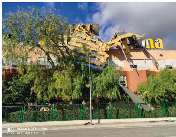
Destrozos en la cubierta de una nave en Xixona el 22 de enero de 2021. Foto aportada por MeteoXixona
