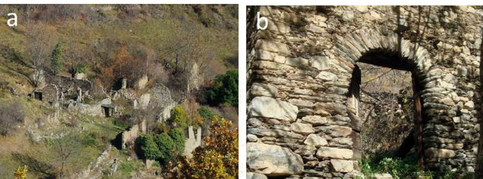
Figura 3. (a) Ruinas del viejo Àrreu, conocido hoy día como Bordes d'Àrreu; (b) algunas características arquitectónicas como este arco de puerta revelan que las ruinas del viejo Àrreu habían sido casas antes de ser usadas como bordas.
