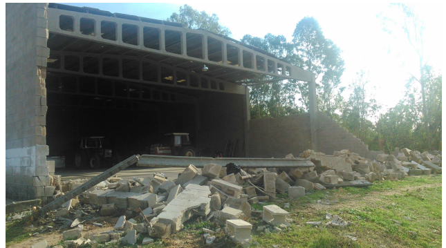
Figura 6. Imágenes de algunos daños observados
